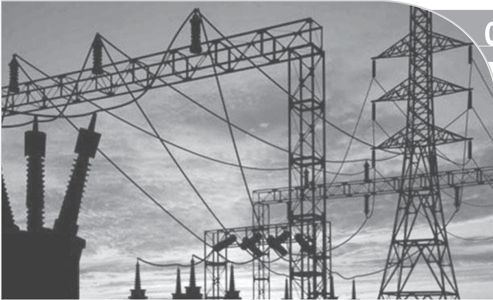
صور لأحد خطوط الربط الكهربائي
