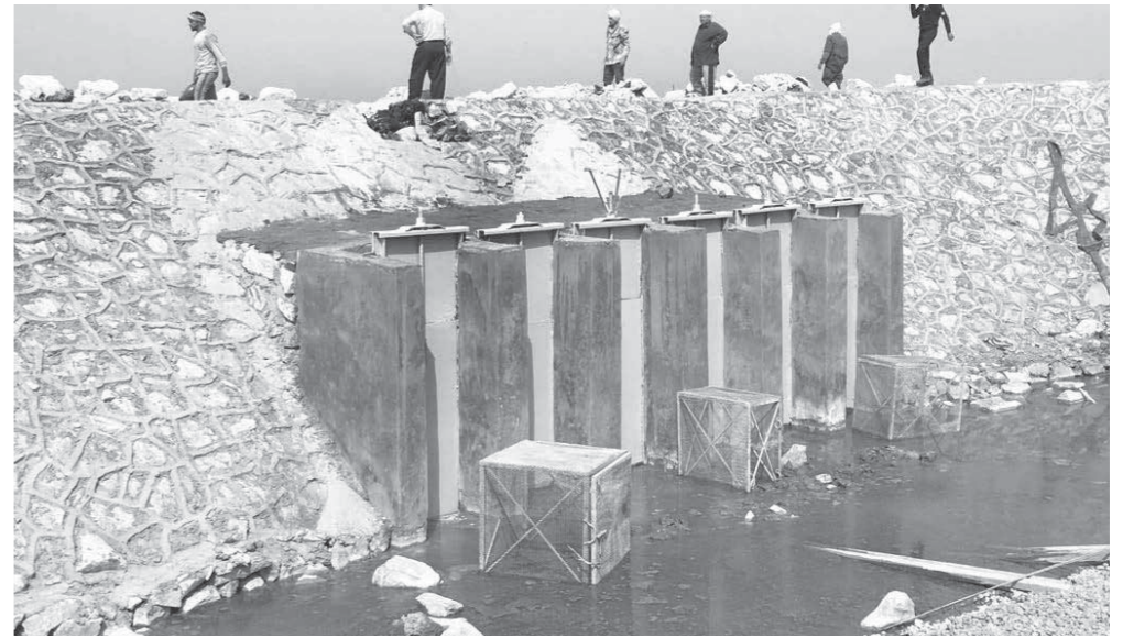
أحواض التكرير لمياه الصرف الصحي
