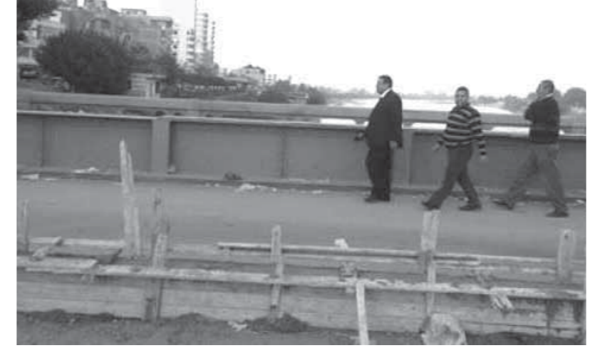
استخدام الخرسانة فى ترميم كوبرى سمنود أفسد معالمه التاريخية
