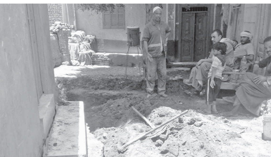
تأكل مواسير مياه الشرب
