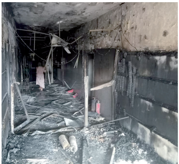
آثار الحريق في مباني المستشفى
