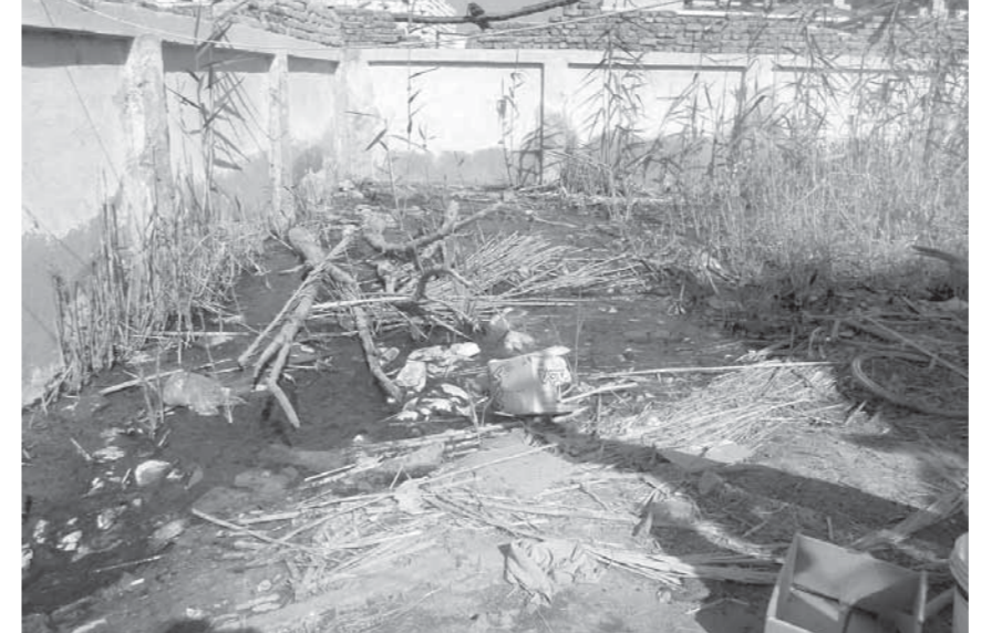
المياه الجوفية تهدد المباني بالانهيار
