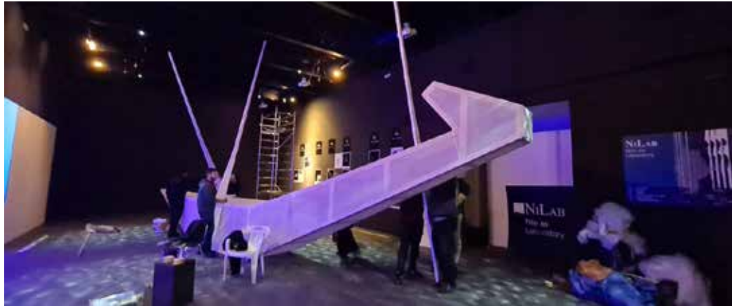
الانتهاء من تنفيذ المشروع الممثل لمصر «نيلاب» في مسابقة بينالي فينيسيا للعمارة
